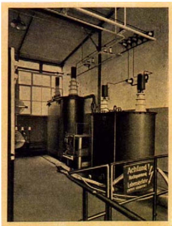
Bild 93. Versuchs- und Prüfanlage für Wasserkühlröhren im neuen Telefunken-Laboratorium, Wernerwerk, Siemensstadt: Die beiden großen Hochspannungstransformatoren. Sie liefern in Verbindung mit Ventilen bis zu etwa 20000 Volt Gleichspannung für die Anodenstromzufuhr bei Leistungen bis über 100 Kilowatt.
