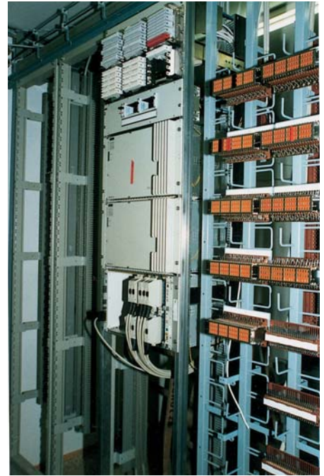
Bild 3: Schaltstelle eines Betriebsfernprechersystems BF 80 / DIKOS 210
